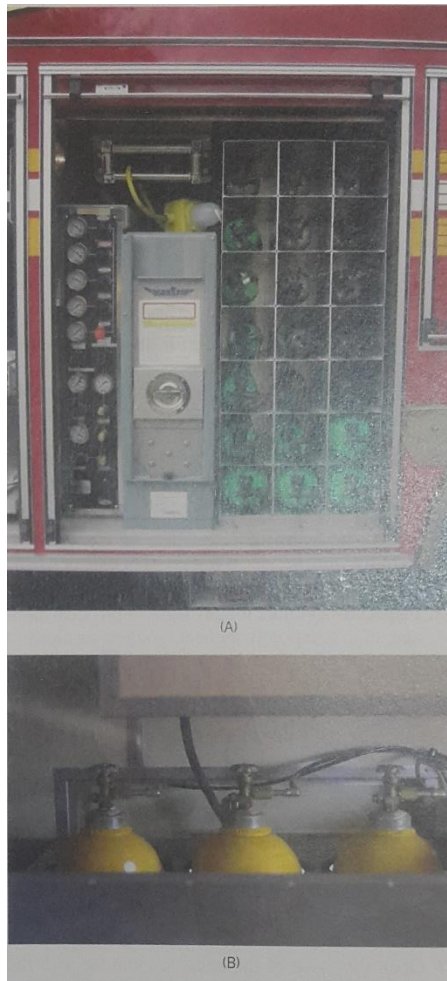
شکل (۶-۲۶) سیستم آبخار یکی از سیستم‌هایی است که در اختیار سرویس سیلندرهاى SCBA قرار دارد. این ممکن است واحدهای ثابت یا متحرک باشد.
